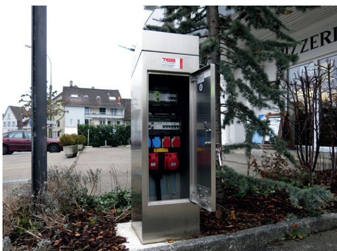
Colonnina d'energia elettrica QUADRO
